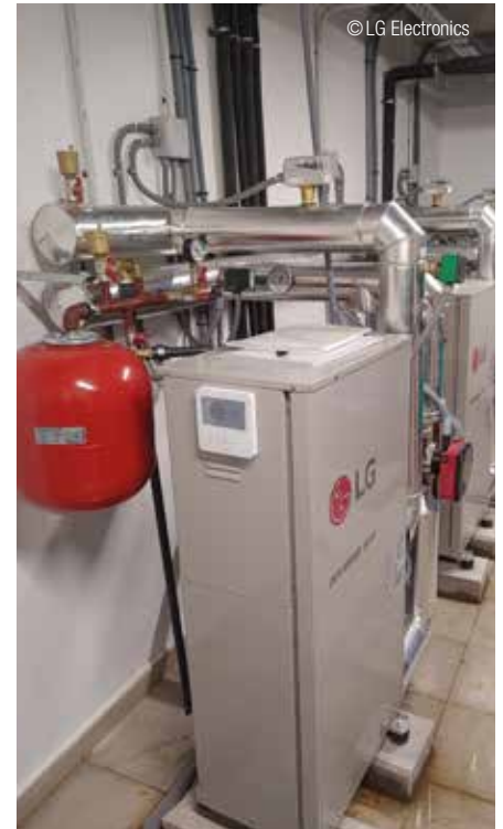
Technikräume und Schaltschränke spielen eine entscheidende Rolle in der zentralen Produktion. Technical rooms and control cabinets play a critical role in the centralized production.
