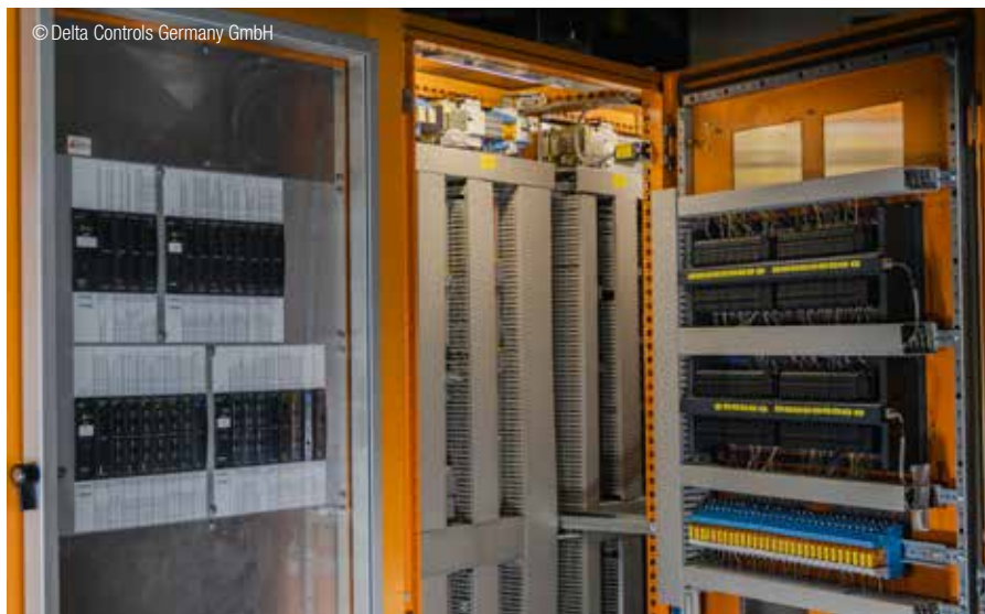
Gebäudeautomatenschaltschrank im Keller der Gebäude am Potsdamer Platz. Building automation control cabinet in the basement of the buildings at Potsdamer Platz.
