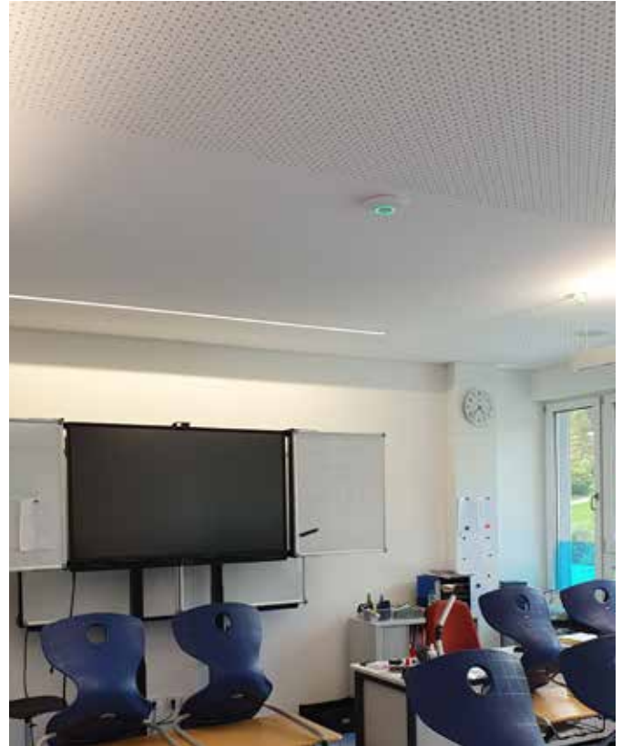
Lighting scenario in a classroom with control by O3 multisensor. Beleuchtungsszenario in einem Klassenzimmer mit Steuerung durch O3 Multisensor.
